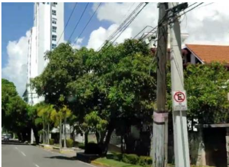
Vista de las redes eléctricas de EDESUR.
