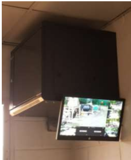
Figura No. 16.- Cabina de control.
