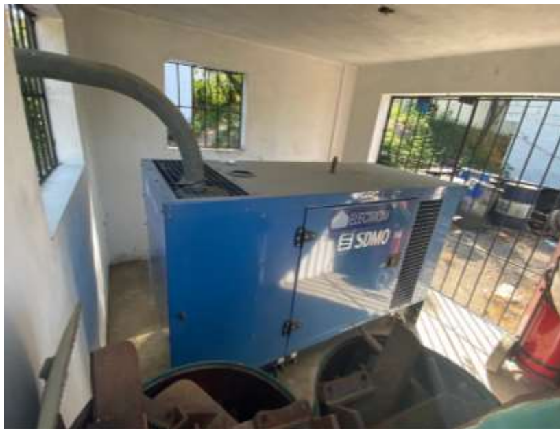
Figura No. 19.- Generador eléctrico SDMO de 25 kW.
