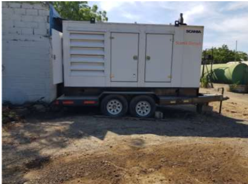
Figura No. 18.- Generador eléctrico SCANIA de 350 kW.
