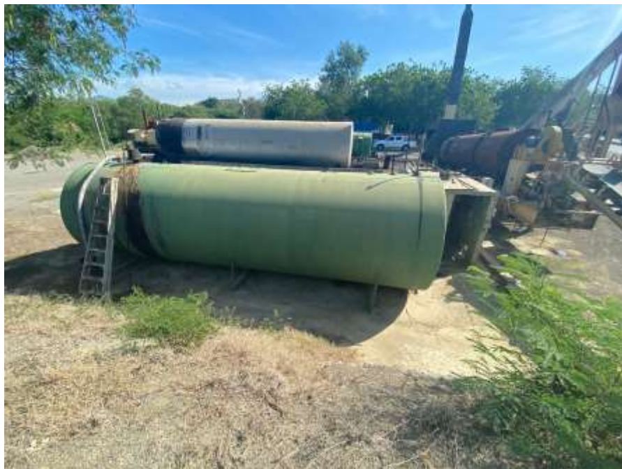
Figura No. 10.- Tanques de almacenamiento de AC-30 y de Fuel Oil.
