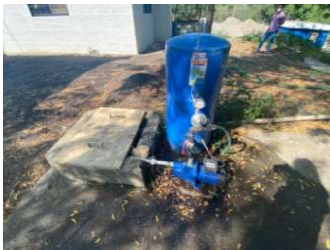
Figura No. 21.- Bomba de impulsión de agua.
