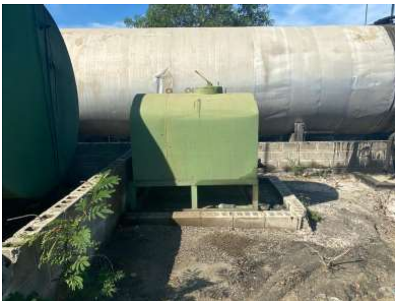
Figura No. 11.- Tanques de almacenamiento.
