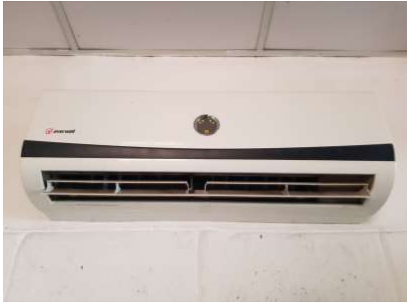
Figura No. 20.- Aire acondicionado.
