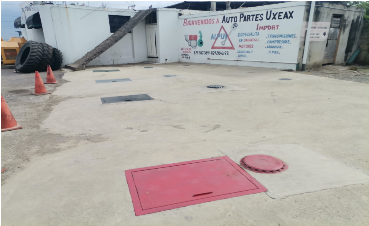
Foto Area de tanques y transito.
