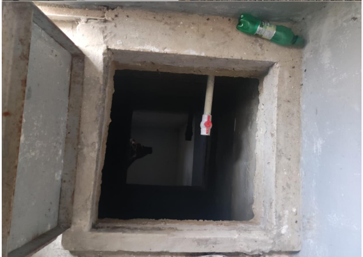
Foto Señalizaciones y cisterna
