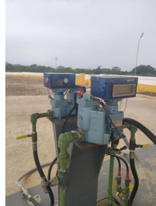
Foto Equipos de GLP
