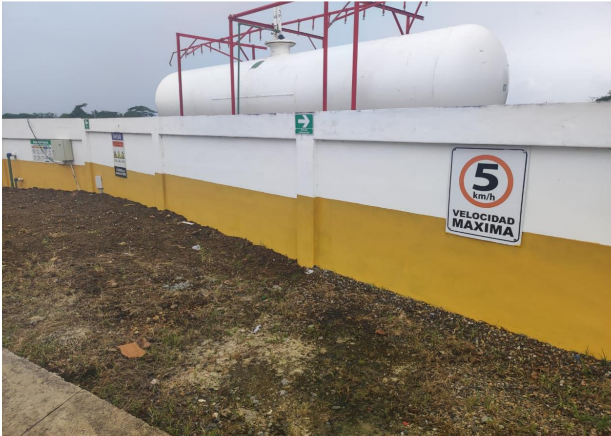
Foto: Área de tanque de GLP.
