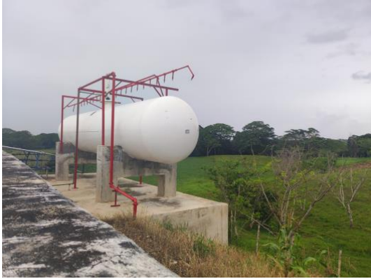
Foto Tanque de GLP
