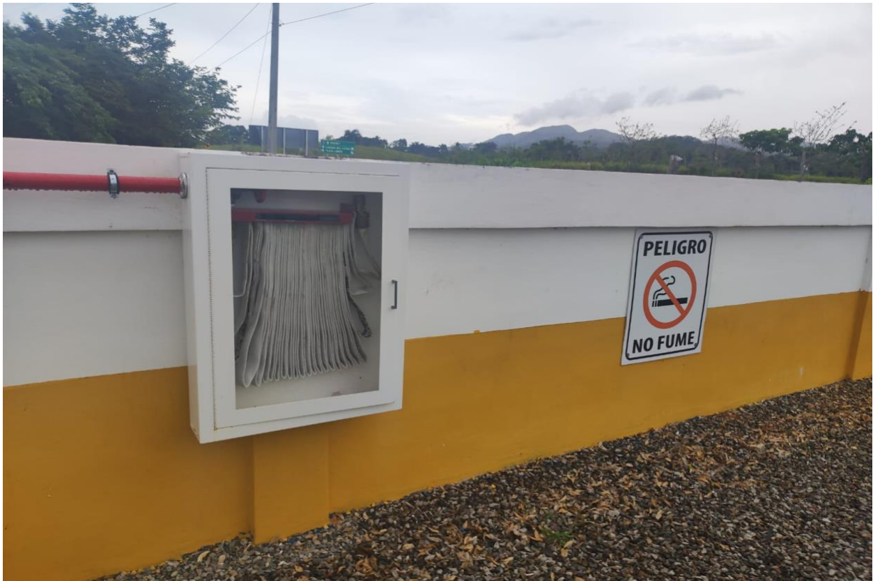
Foto: Motobomba/generador y manguera contra incendio.
