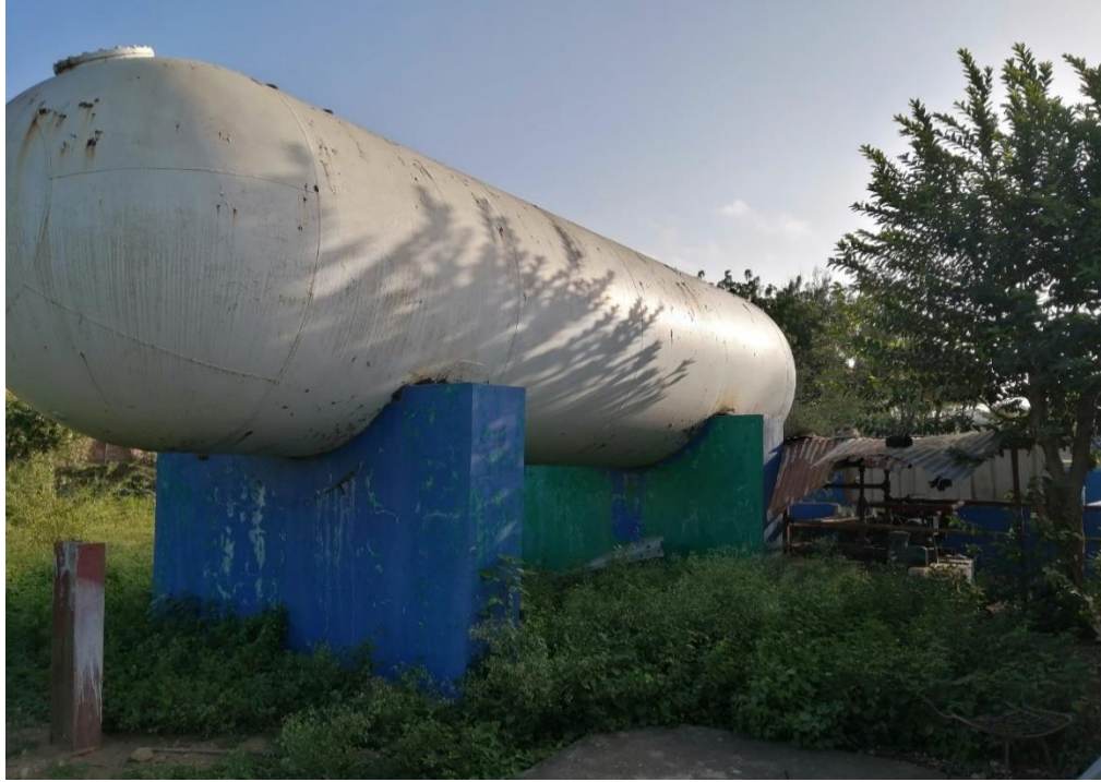
Tanques de almacenamiento de GLP
