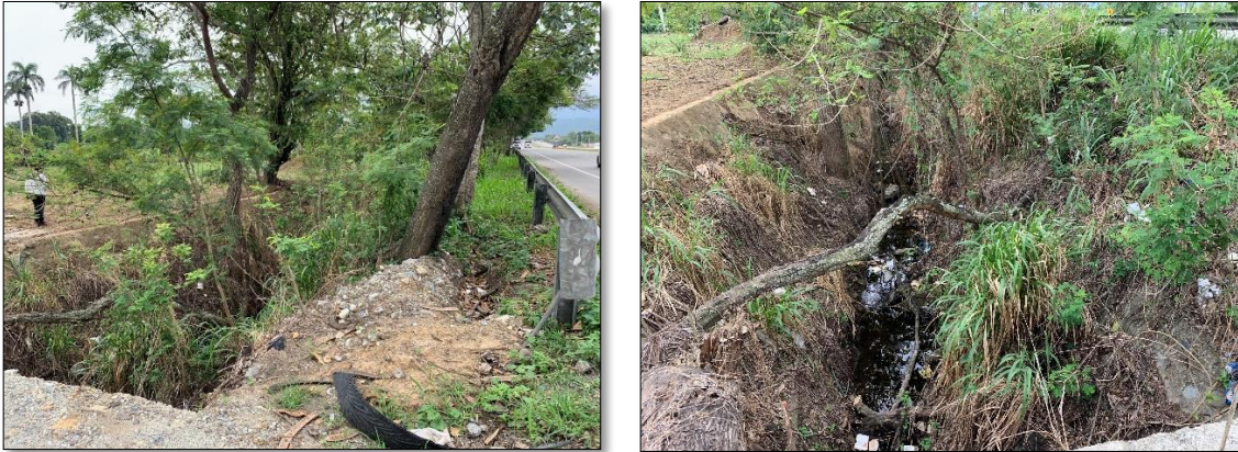
Imágenes No. 10 y 11. Canaleta o canal enchado, realizado para el desagüe pluvial.
