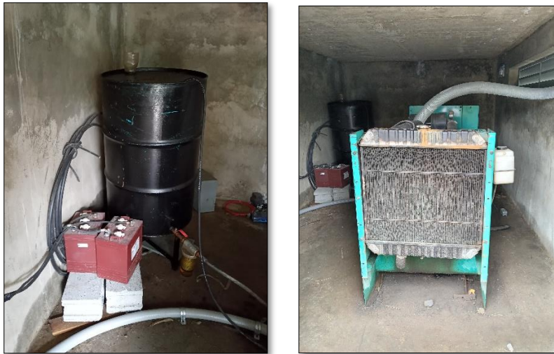
Imágenes No. 16 y 17. Tanque de almacenamiento de combustible de 55 galones y generador eléctrico instalados en el proyecto.
