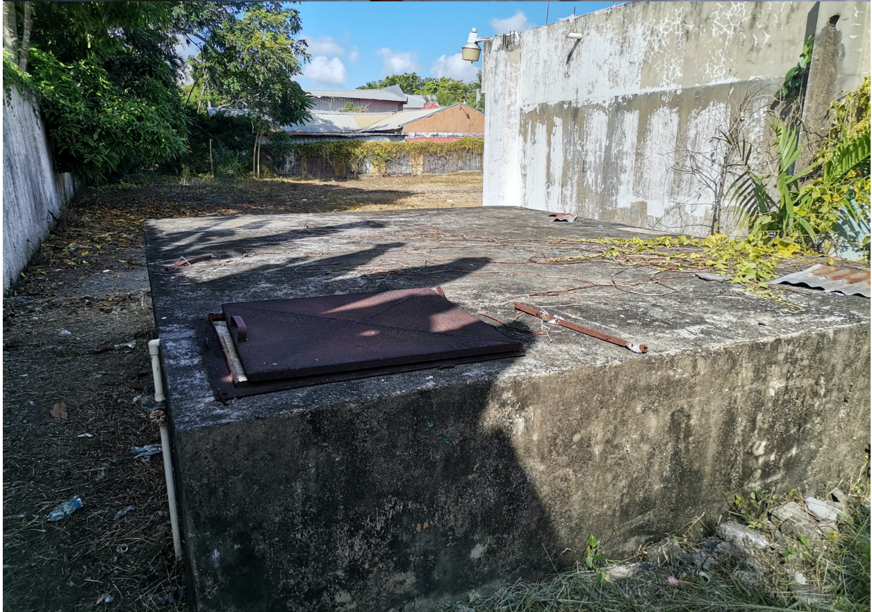
Foto Tanque diesel del generador y cisterna
