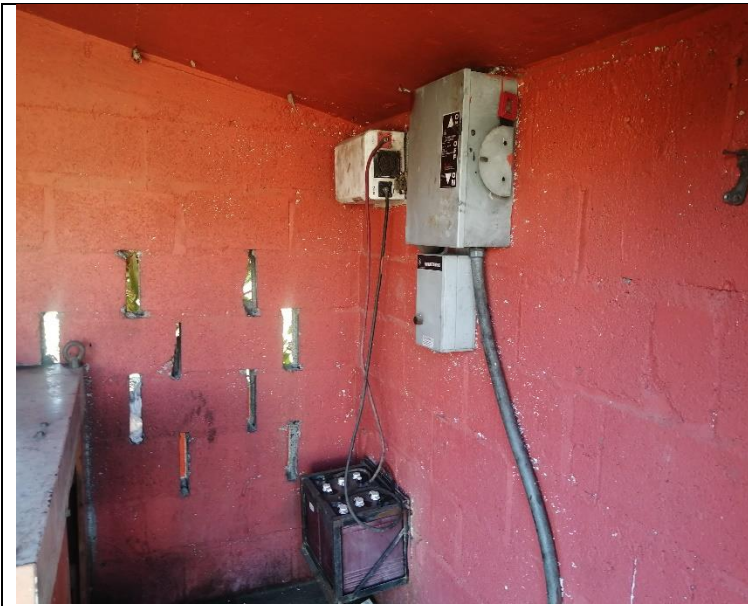
D4. Inversor eléctrico y batería
