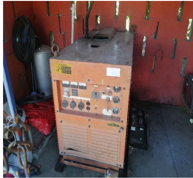
D1. Generador eléctrico
