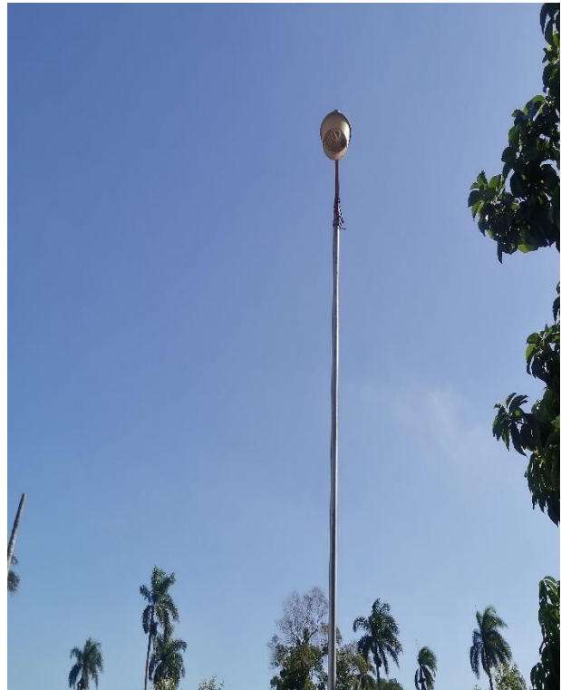
D7. Poste iluminación
