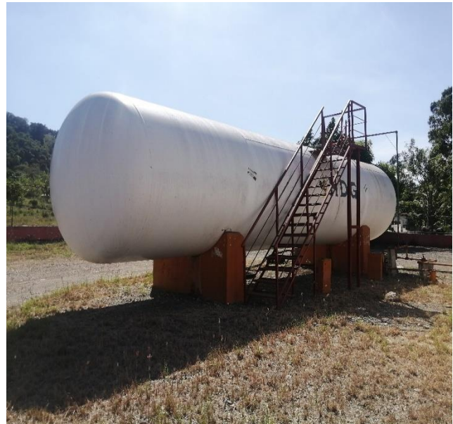
A4. Tanque GLP con escalera de servicio
