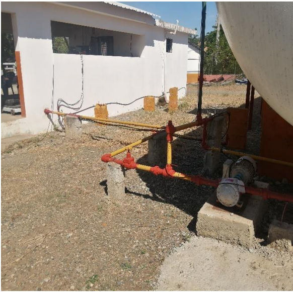
A3. Distribuidor GLP tanque dispensador.
