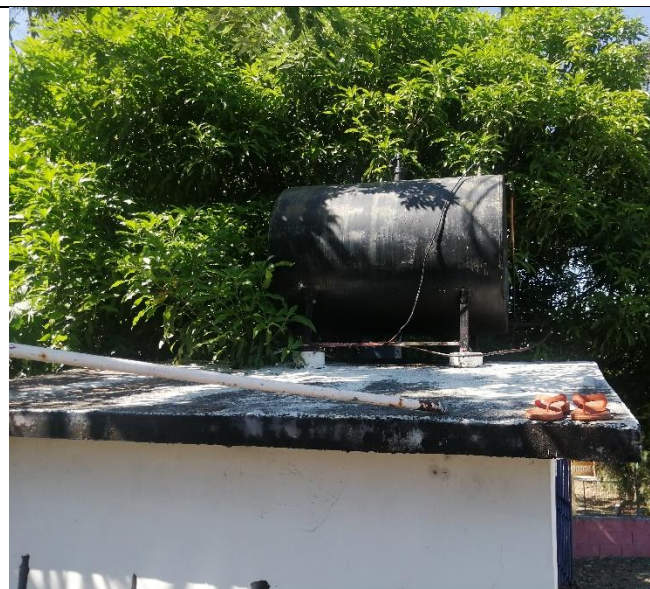
D3. Tanque gasoil almacenamiento
