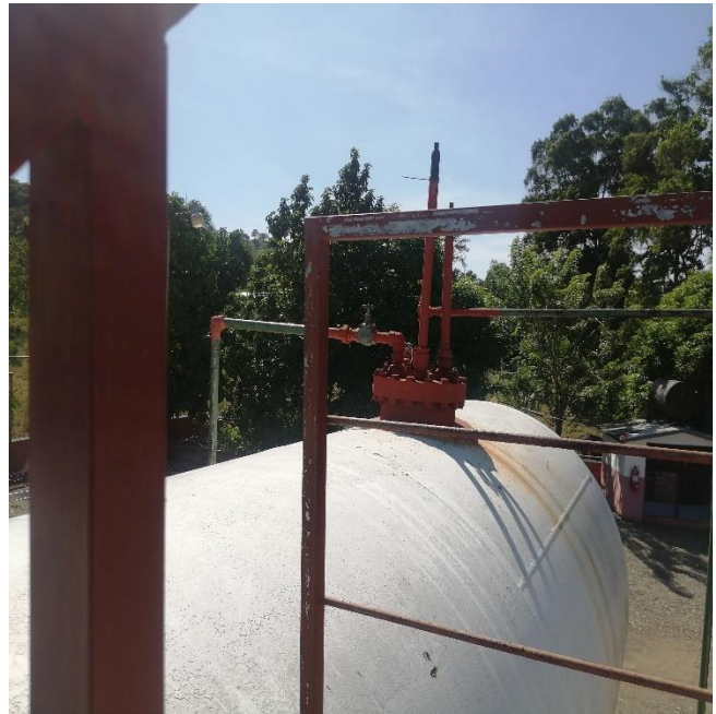
B6. Sistema de Aspersores control incendio
