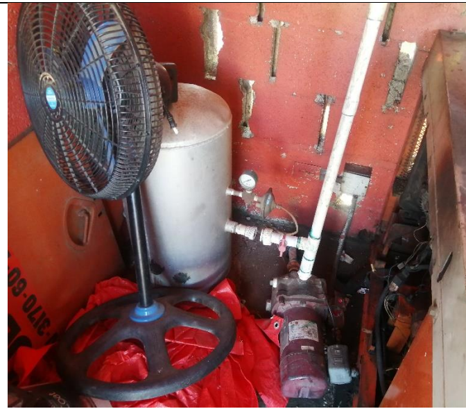
D5. Bomba de agua y tubería
