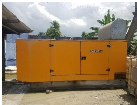
Foto 6. Generador eléctrico 75 kwh.
