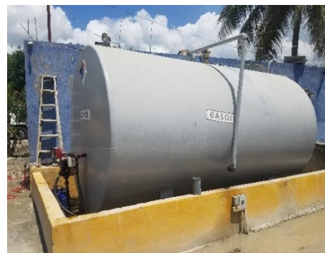
Foto 7. Tanque de almacena miento y expendio de combustible.
