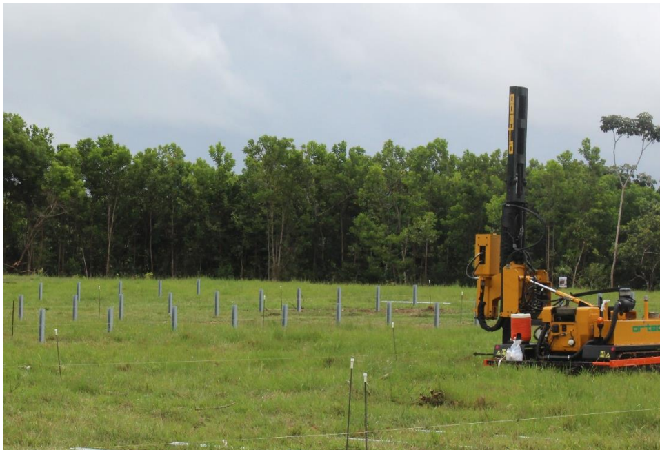
Foto 1. 3 Postes hincados y máquina hincapostes. Obsérvese que no fue necesario modificar el terreno natural. Fuente: imagen propia tomada durante la construcción de PSF de Akuoenergy, mayo 2022
