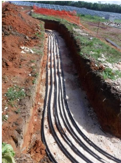
Foto 1. 1 Cableado de media tensión. Fuente: imagen propia tomada durante la construcción de Parque Solar Fotovoltaico propiedad de Akuoenergy
