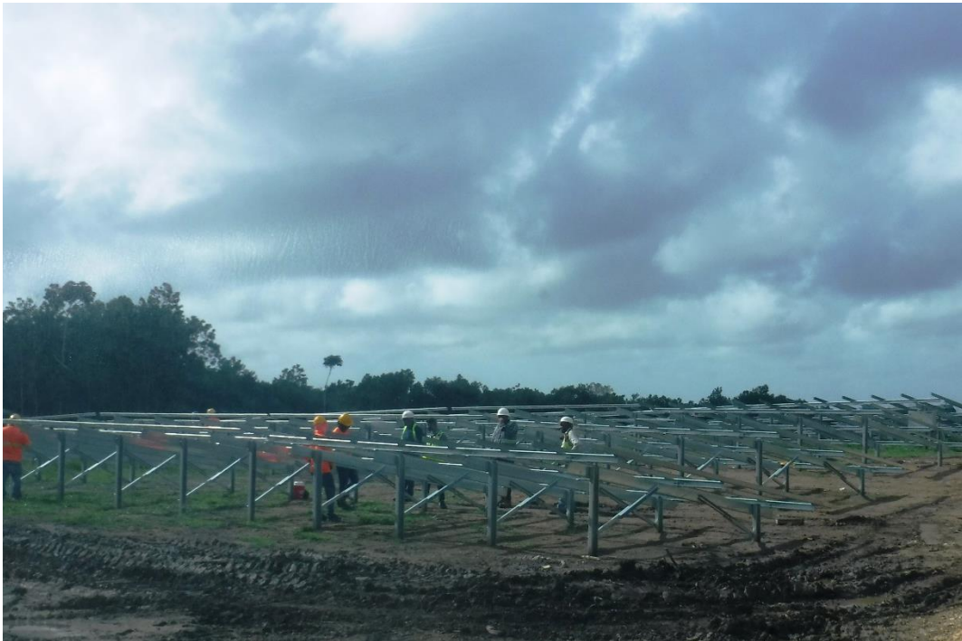
Foto 1. 4 Ensamblado de estructuras de soporte de los paneles. Fuente: imagen propia, PSF de Akuoenergy.
