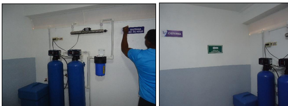
Vista del sistema de tratamiento de agua potable
