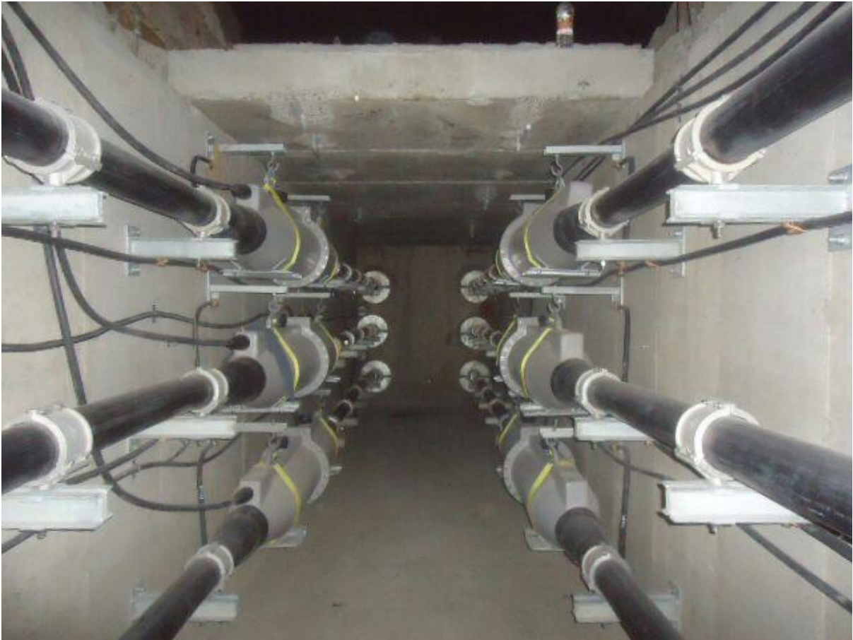
Foto 2.8. Ternas de conductores en un registro soterrado
