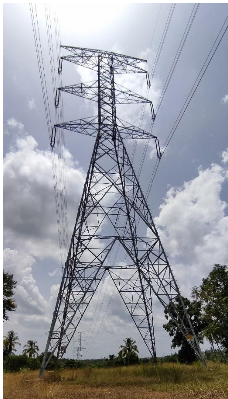
Foto 2.1. Torre de transmisión para línea a 345 kV
