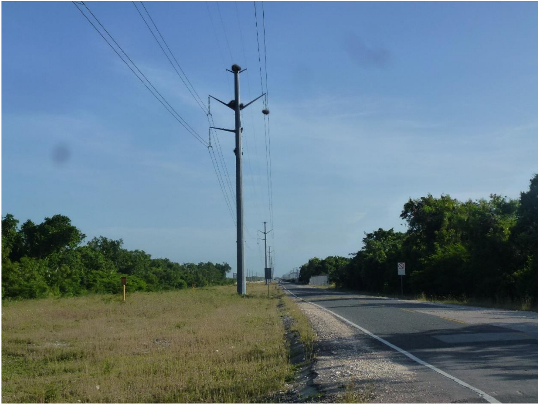
Foto 2.2. Vista de los postes metálicos tipo Petit-Jean
