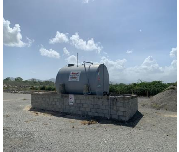
Foto 3. Tanque de Diesel 5000 galones.
