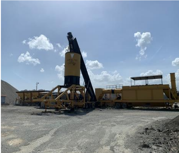
Foto 2. Planta productora de asfalto.
