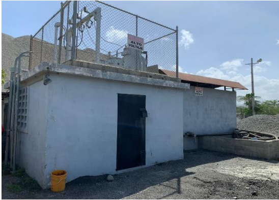
Foto 7. Banco de transformadores.
