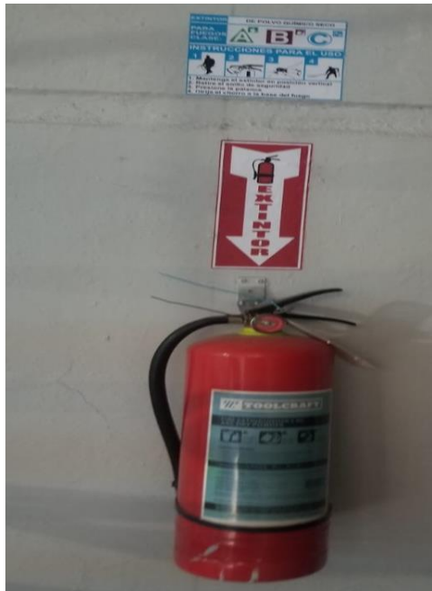
Extintor entrada oficinas.
