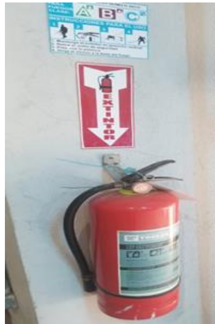
Extintor entrada nave.
