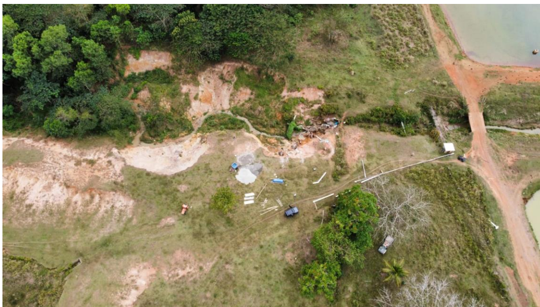
Fotografía 6. Deslizamiento en la descarga de aguas pluviales (vista aérea).
