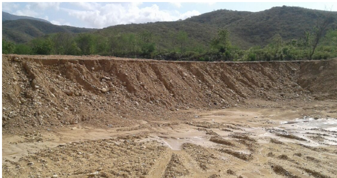
Fuente: Equipo de expertos de JICA, Rehabilitación Vertedero Azua, RD. 2017.- Foto 8. Problemas de erosión en el dique debido a fuertes lluvias
