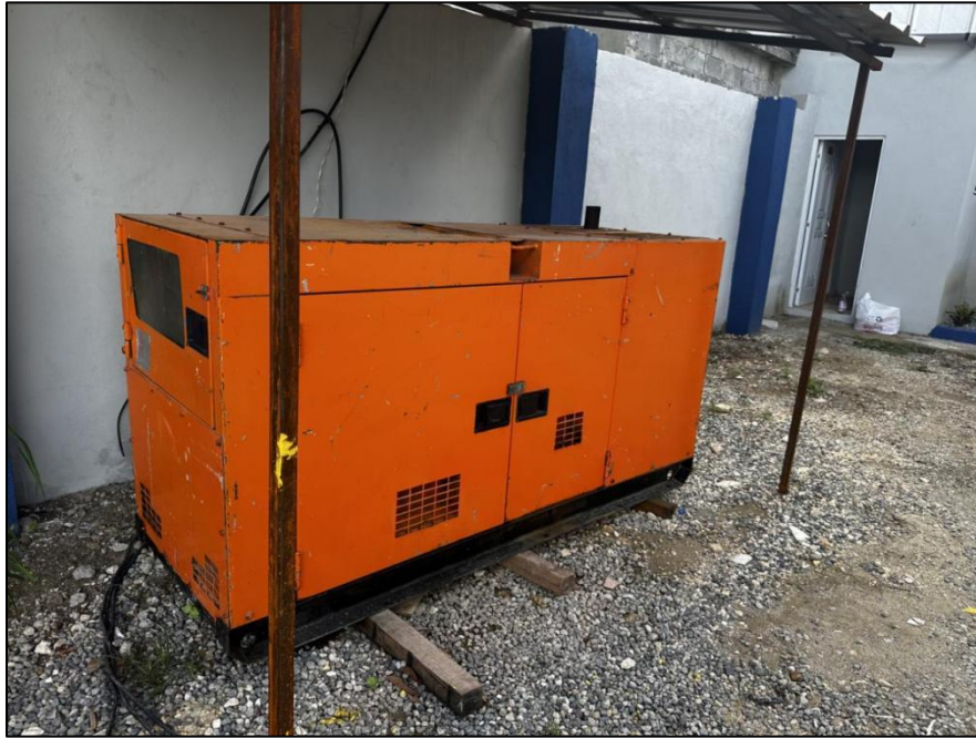
Foto 13.- Planta generadora eléctrica.
