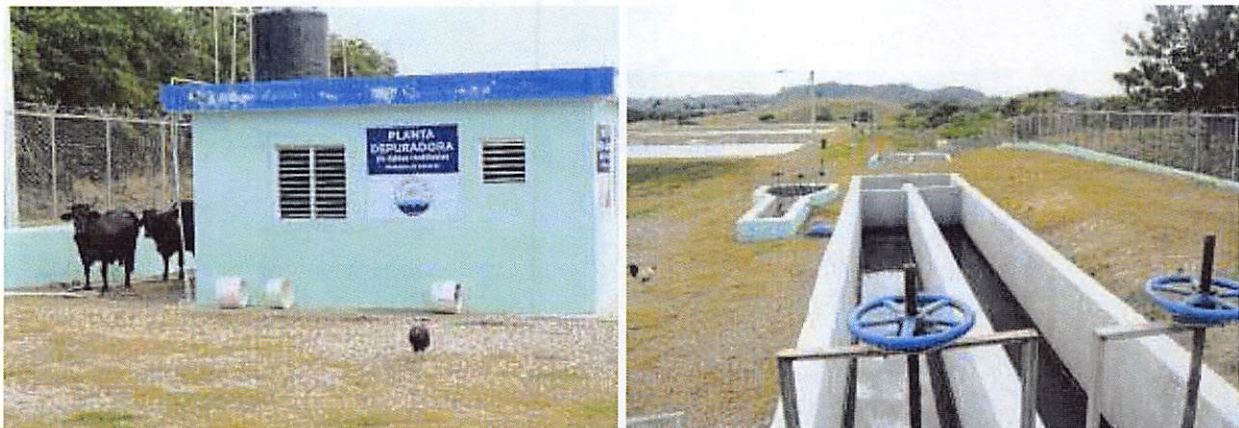
Foto 2.20. Vista de las instalaciones de la Planta de Tratamiento de Aguas Residuales del municipio Luperón.
