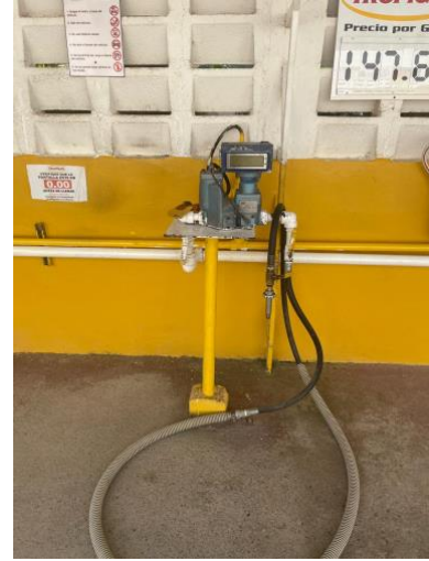
Foto Equipos de GLP
