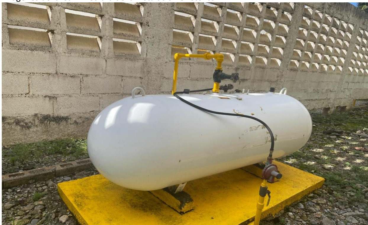
Foto: Tanque de GLP del generador electrico.
