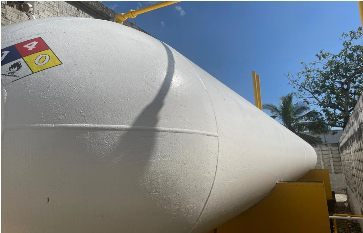
Foto Area de tanque de GLP
