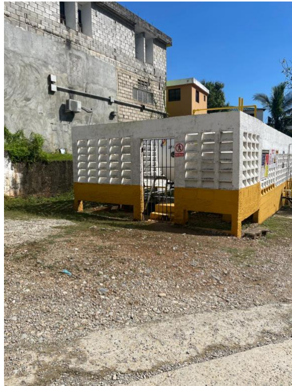
Foto Área del tanque de GLP
