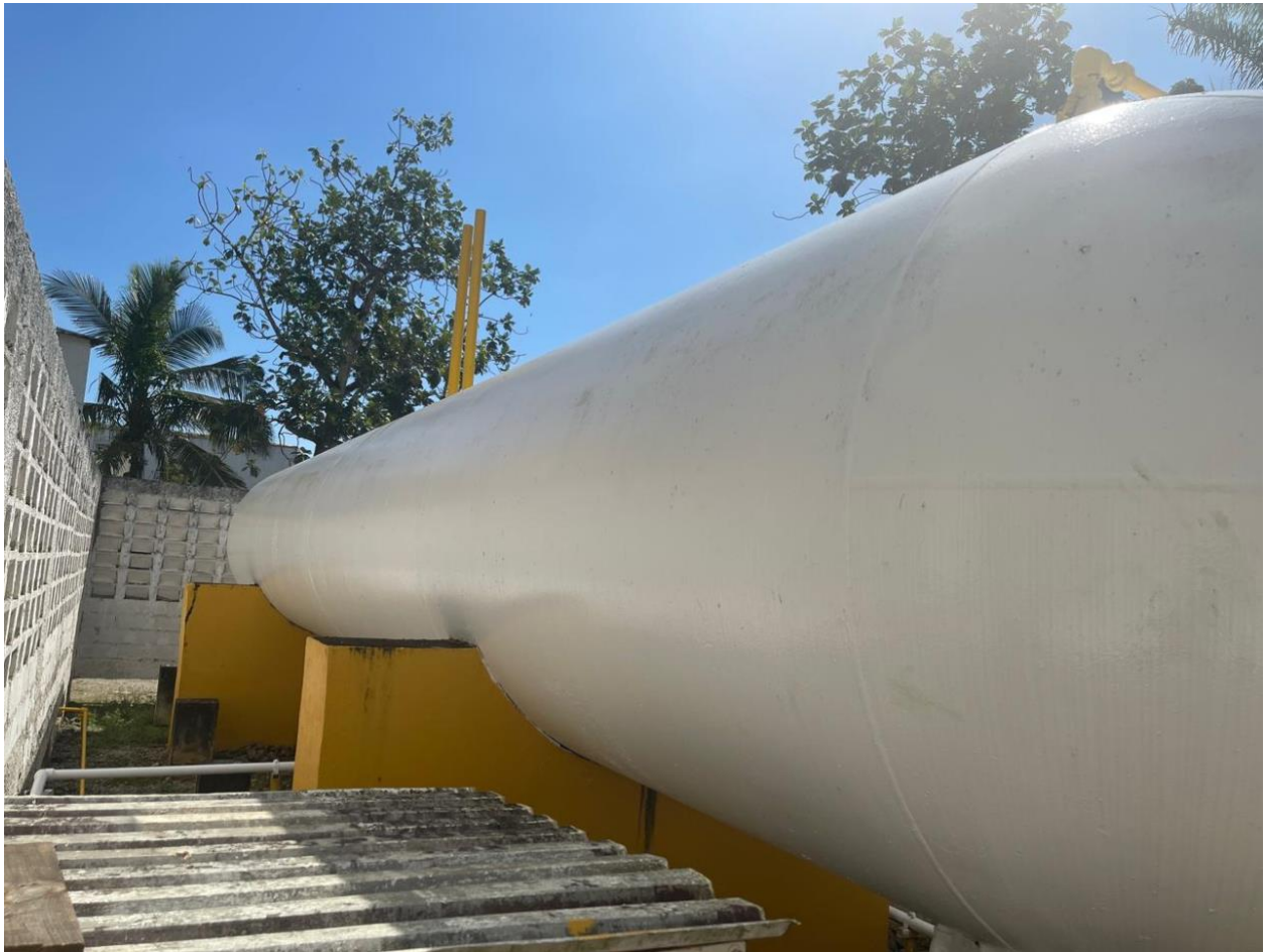
Foto: Área de tanque de GLP.
