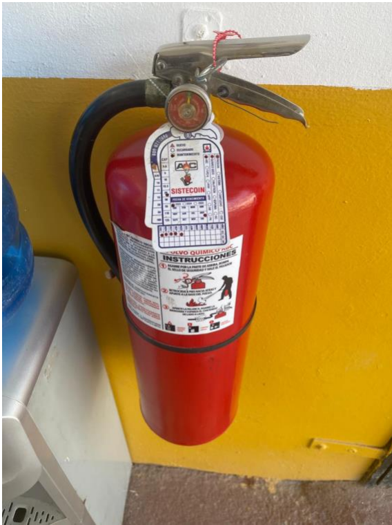
Extintor en área de expendio
