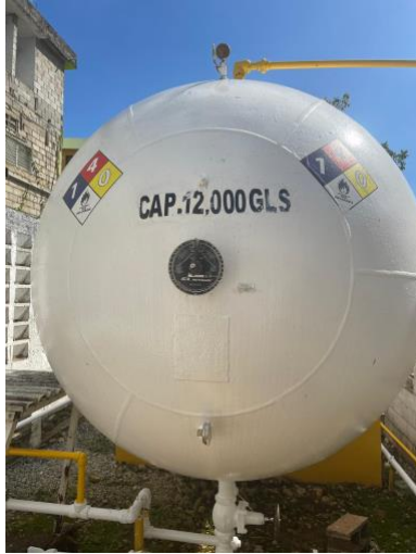
Foto Tanque de GLP
