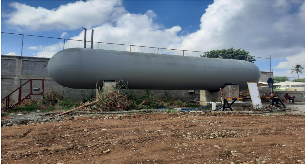
Tanque de almacenamiento de GLP de 18,000 galones de la Envasadora Credigas Licy
