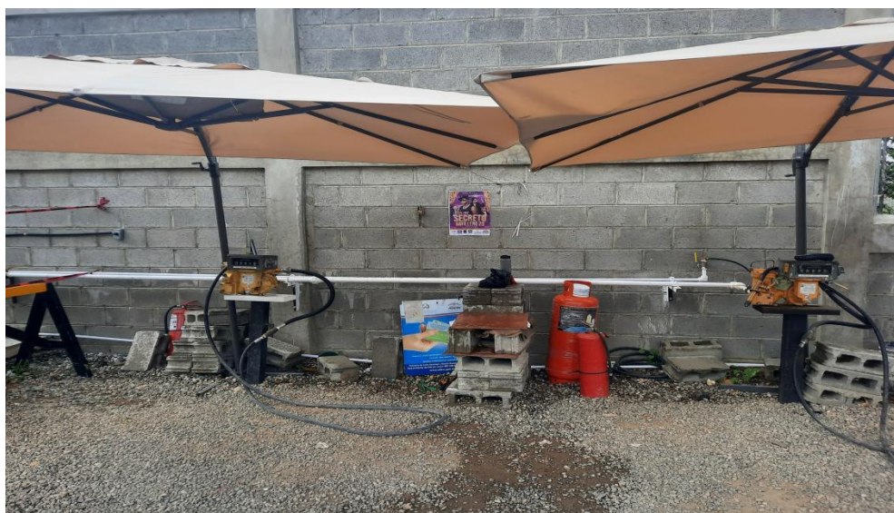
Dosificadores en operación de la Envasadora Credigas Lincey en Remodulación
