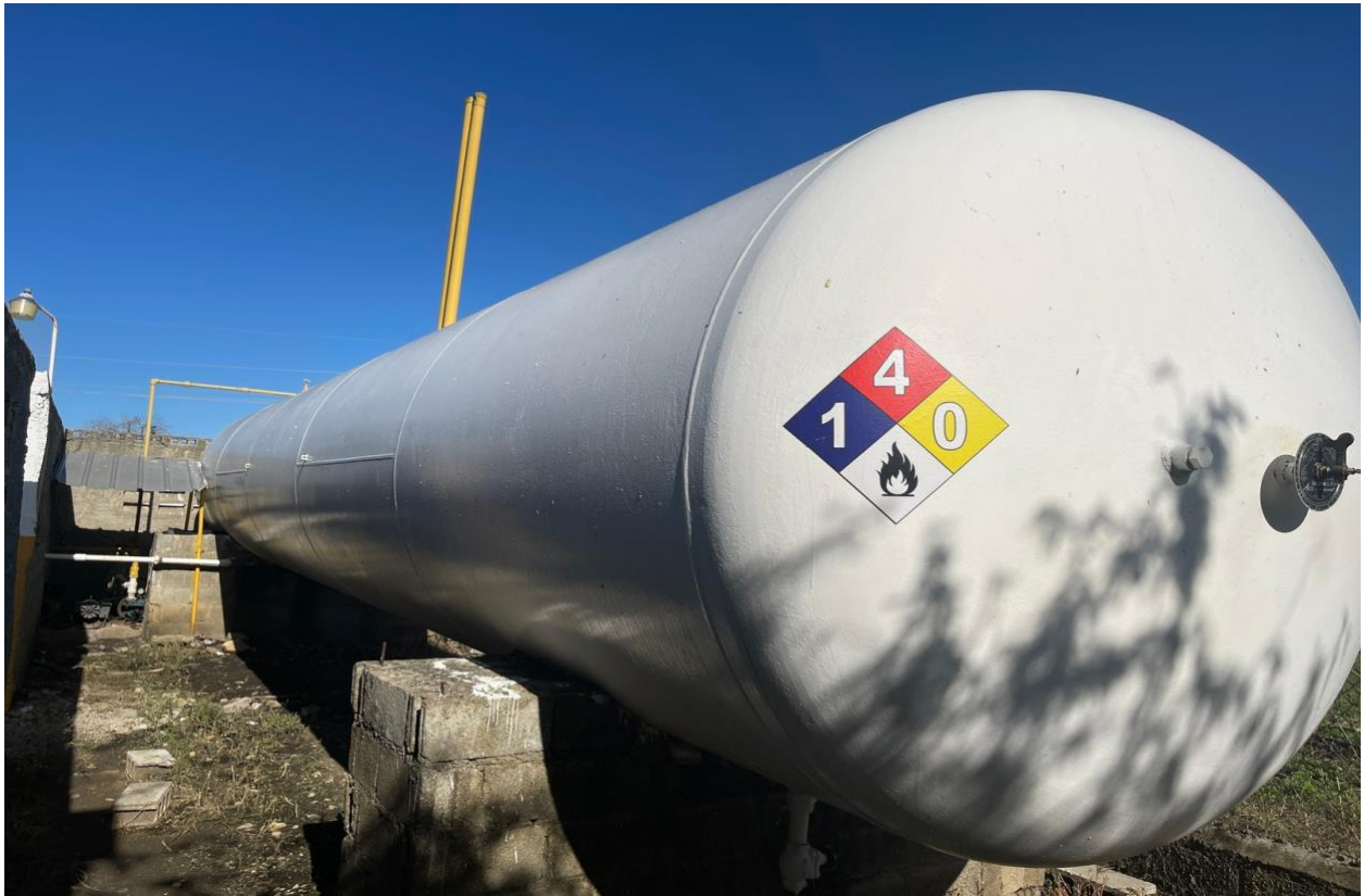
Foto: Área de tanque de GLP.
