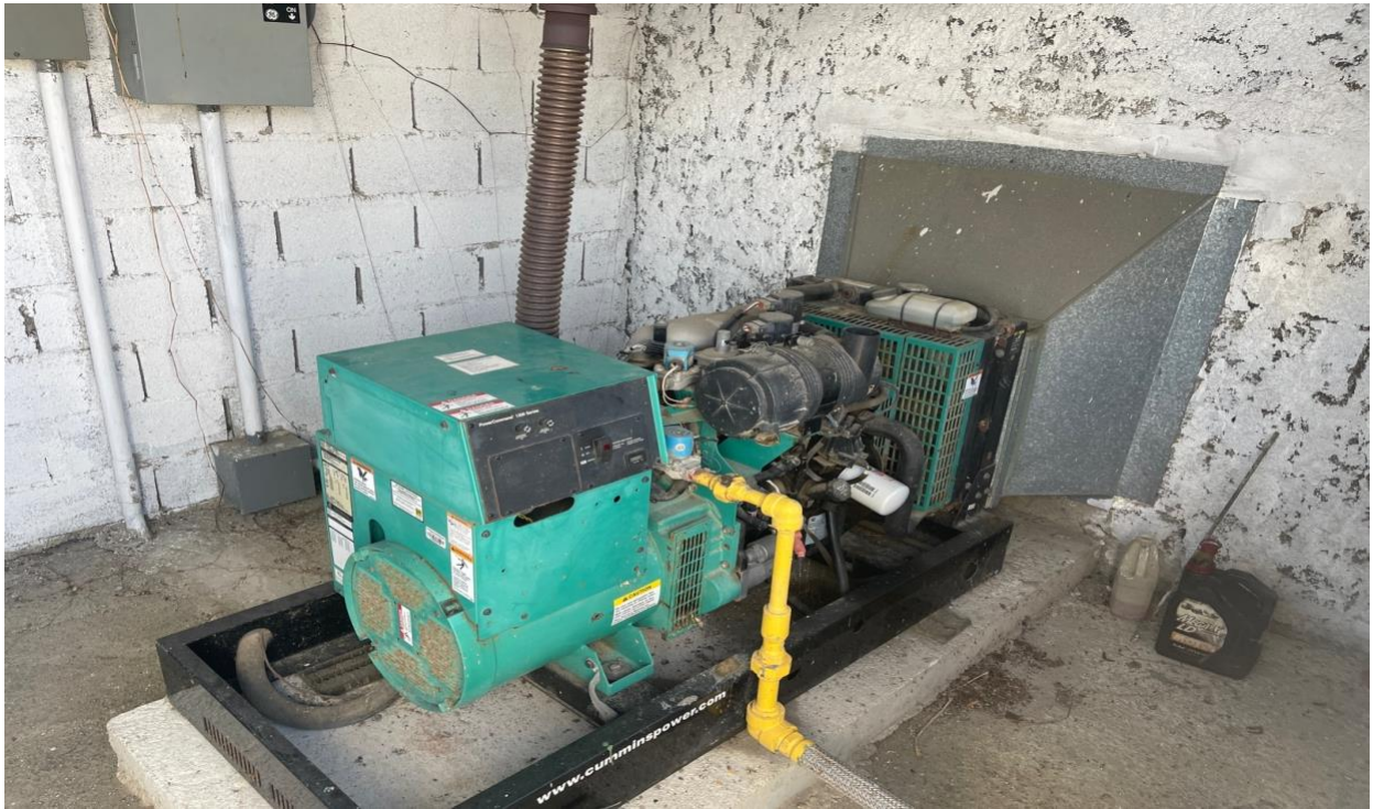
Foto Generador electrico
