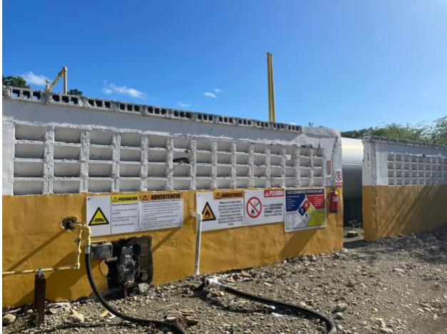
Foto Área de Tanque de GLP
