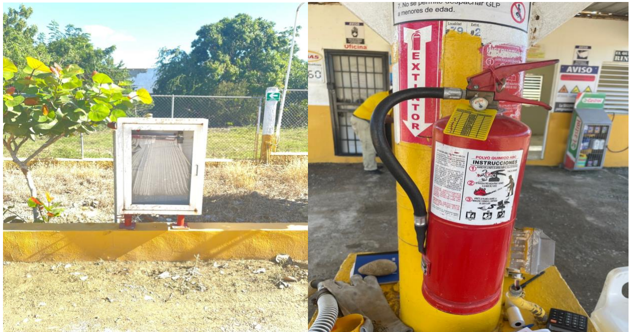
Fotos: Extintor y manguera contra incendios
