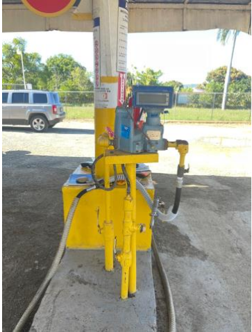
Foto Equipos de GLP
