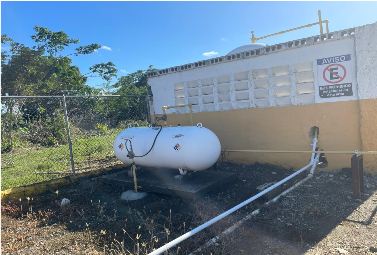
Foto Area de tanque de GLP + tanque de GLP del generador.
