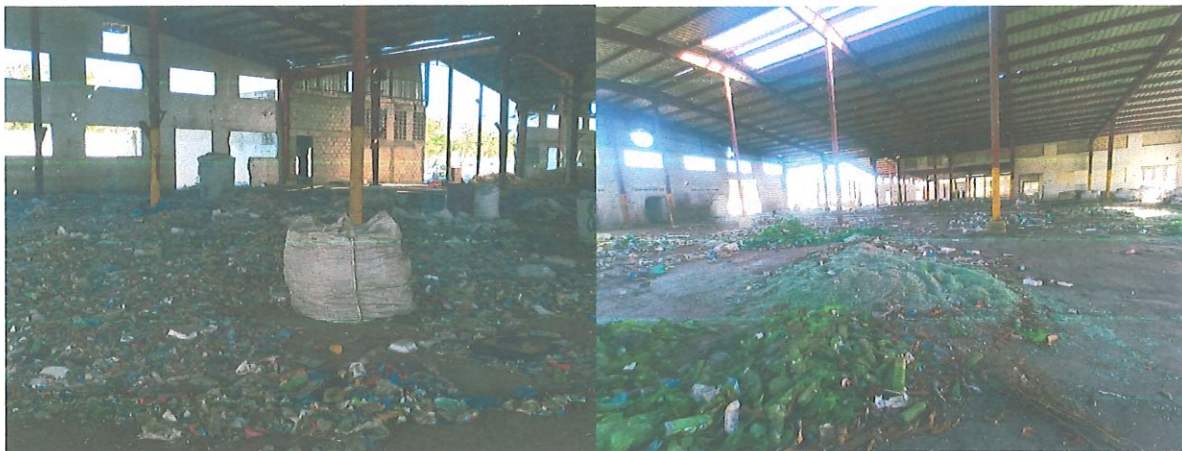
Dentro de la Nave (Area afectada)
