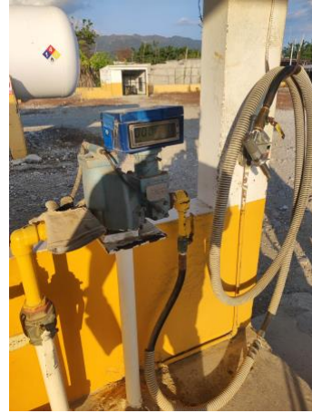
Foto Equipos de GLP
