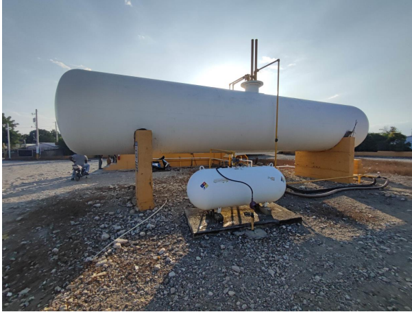
Foto Tanque de GLP
