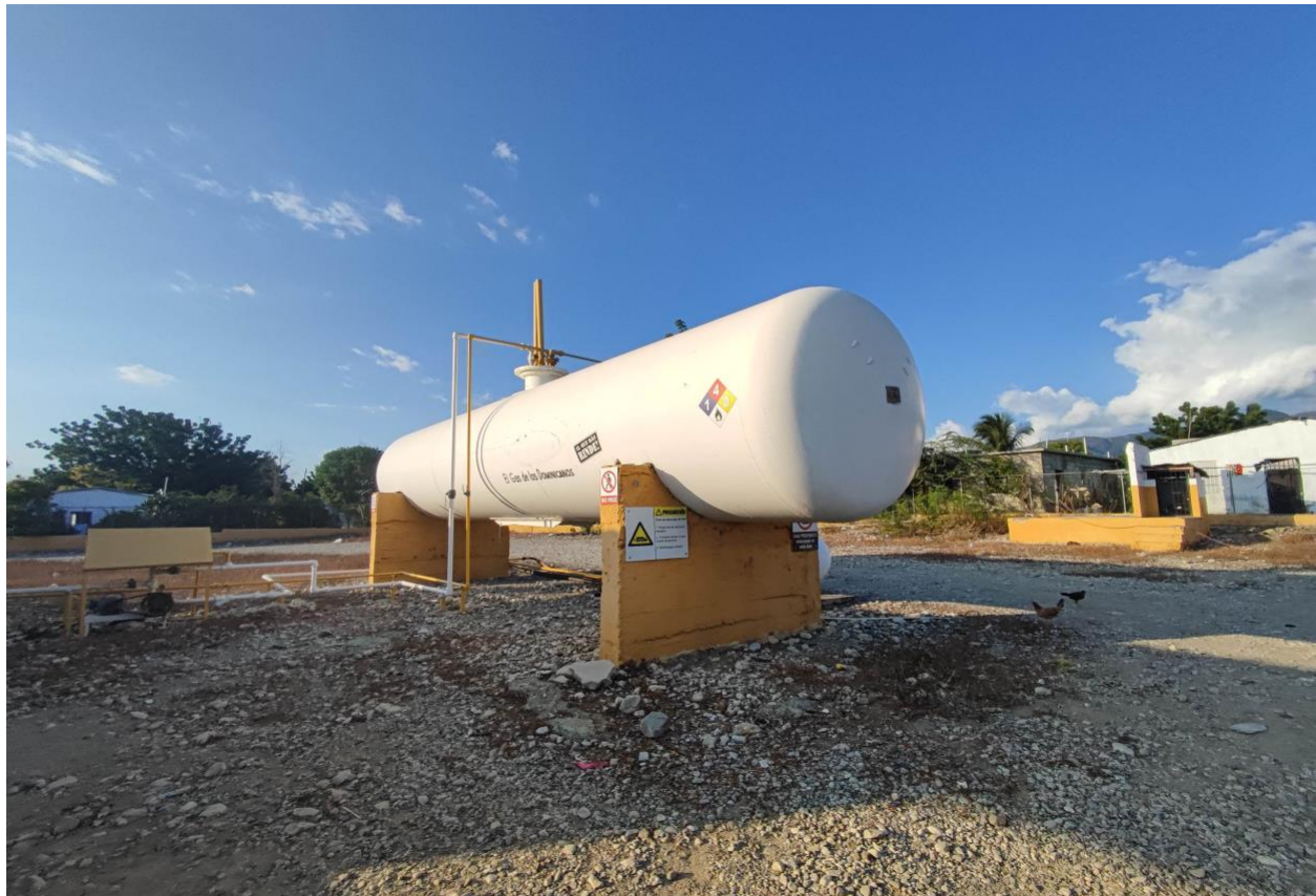
Foto Area de tanque de GLP
