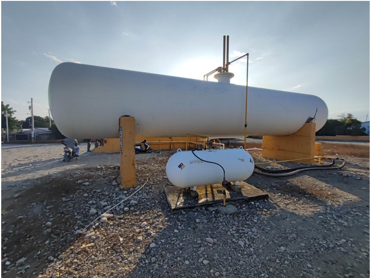
Foto: Área de tanque de GLP.
