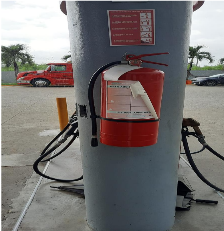
Extinguidores usados en la Estación de Servicios Atlas Texaco
