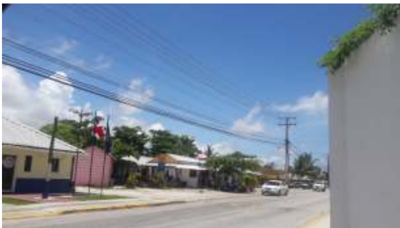
Fotos 2.5.5.5-2. Tendido eléctrico en área de influencia del proyecto.
