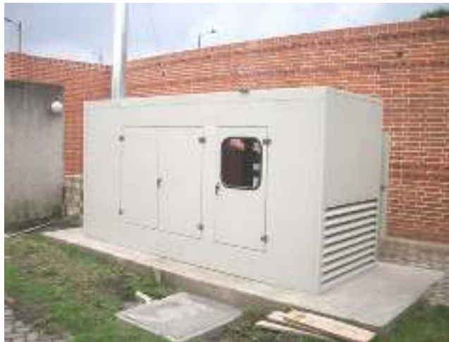
Foto 6.2.1.4-4. Ejemplo de cabina insonorizada para el generador eléctrico. ( https://www.sieingenieria.co/cabinas-acusticas-Insonorizacion.html ).
