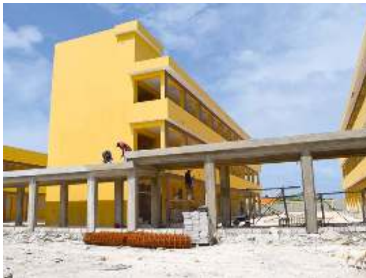
Foto 2.5.5.10-1. Edificio escolar en proceso de construcción en el distrito municipal Verón-Punta Cana.
