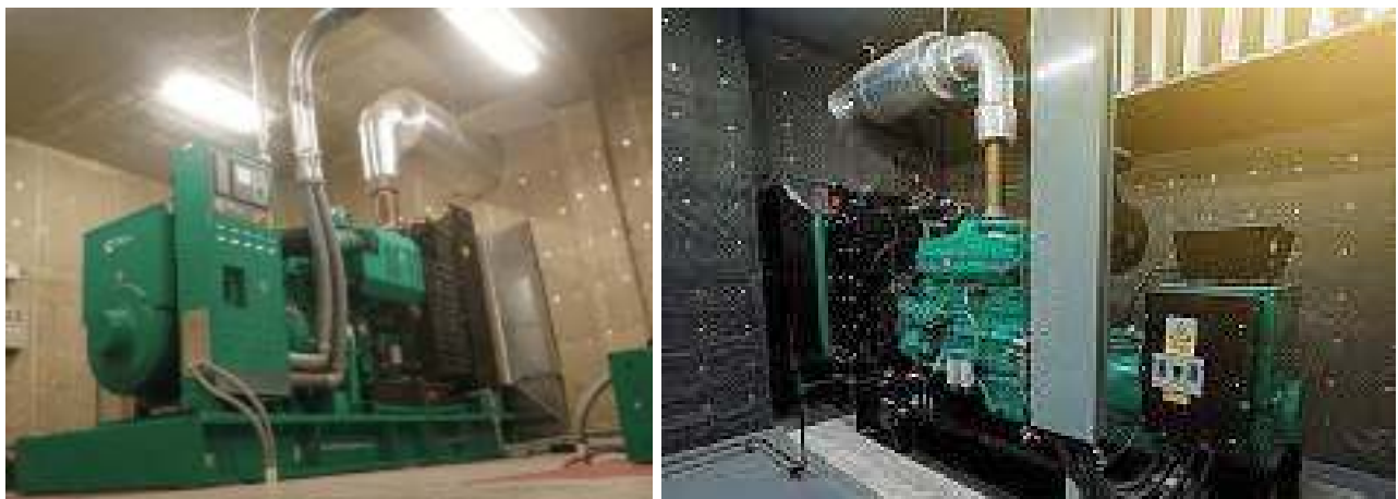
Fotos 6.2.1.4-3. Ejemplo de los elementos aislantes en paredes y techo del local de un generador de electricidad.
