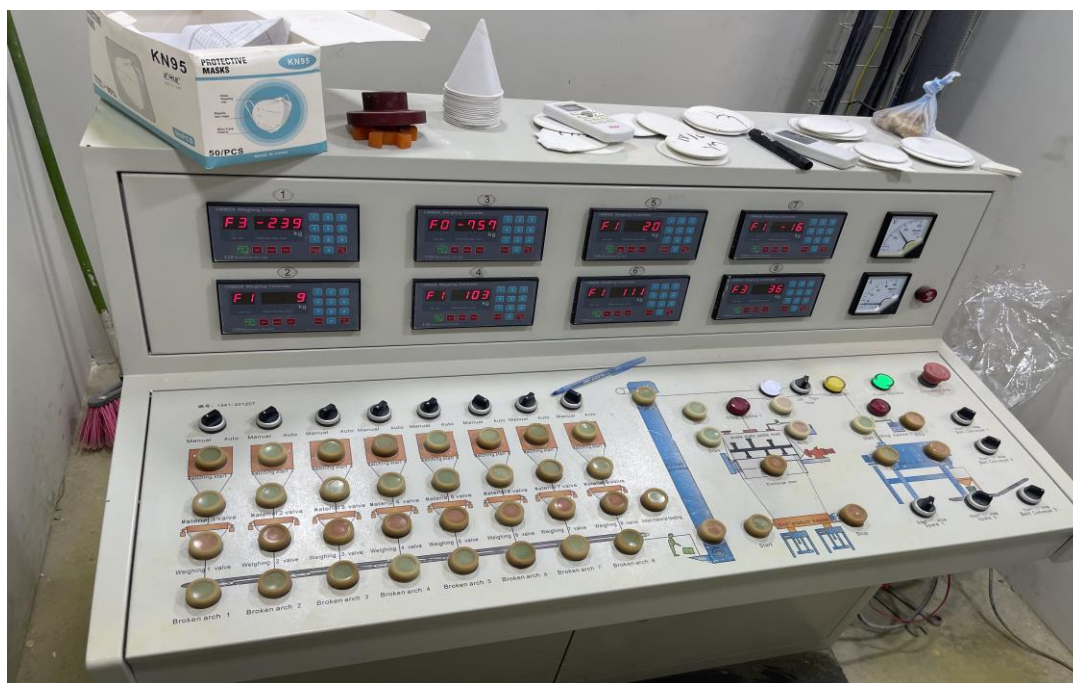
Foto No. 3.- Panel de control del proceso de producción del proyecto
