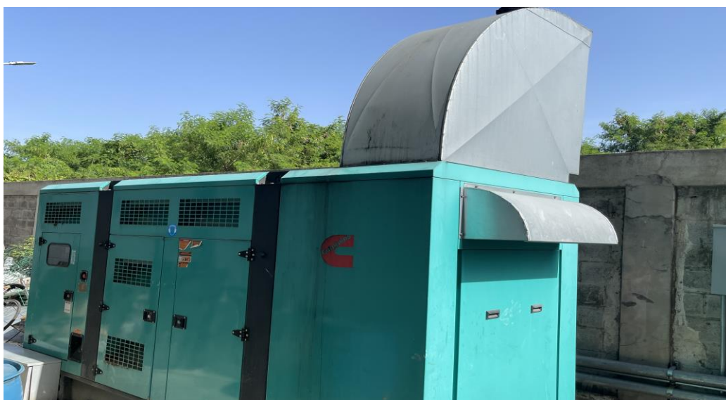
Foto No. 15.- Generador eléctrico de emergencia de la empresa Roig Industrial, SRL.
