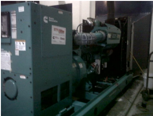
Foto Generador eléctrico
