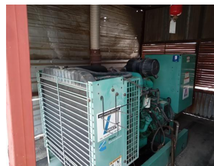
Figura 27: Planta Eléctrica de servicio a la estación de Linde Gas Dominicana SRL (localidad Santiago).
