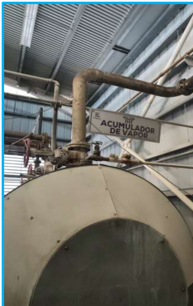
Imagen No. 37: Acumulador de Vapor
