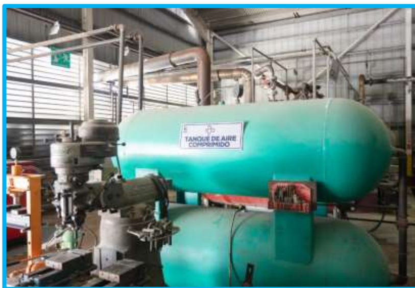
Imagen No. 34-35: Sistema de Aire Comprimido
