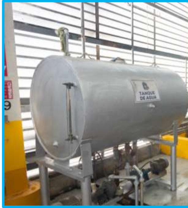
Imagen No. 63: Tanque diario de Agua
