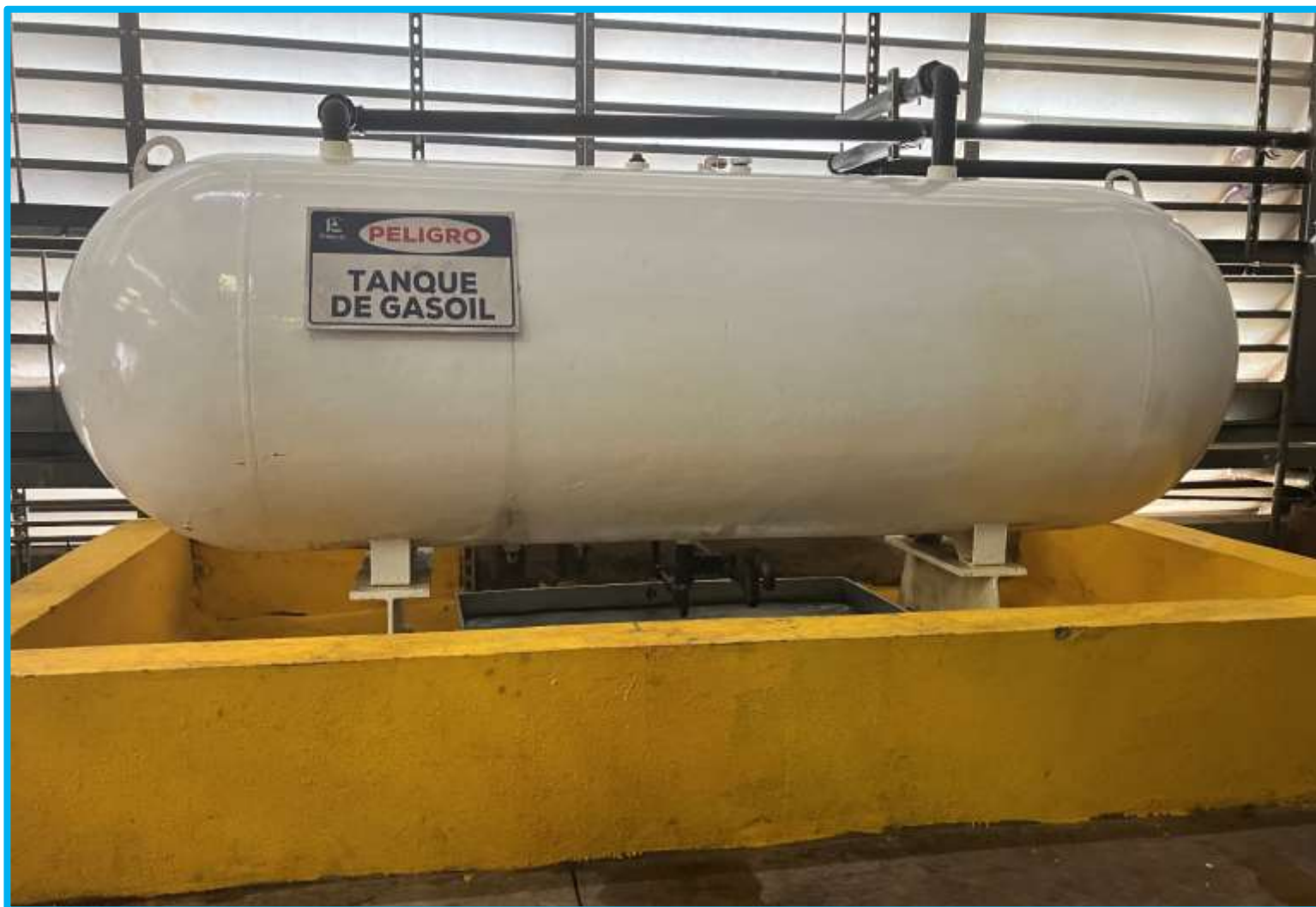
Imagen No. 21: Tanque de Almacenamiento de Gasoil
