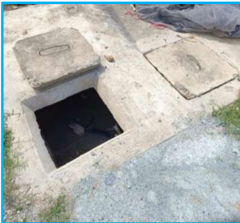
Imagen No. 65: Registro de Aguas Sanitarias
