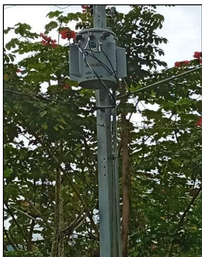
Foto 1.30 Transformador de 75 kW a la entrada
