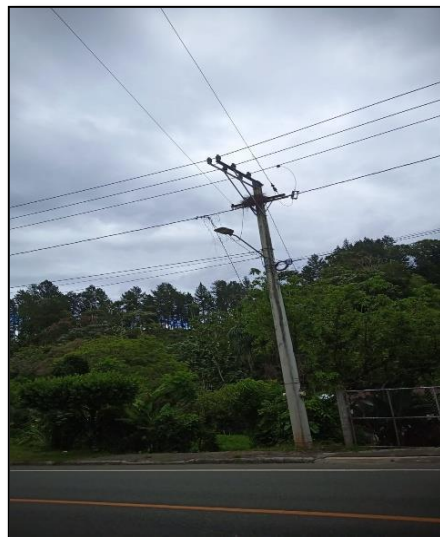
Foto 1.29 Líneas de Conexión Entrada al Proyecto
