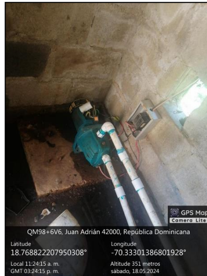
Foto 2.11 Tuberías de entrada a Cisterna A1
