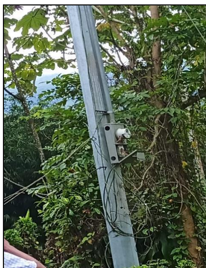
Foto 1.31 Contador actual del proyecto ubicado cercano a la casa N° 3
