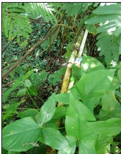
Foto 1.27 Líneas de Distribución de Agua
