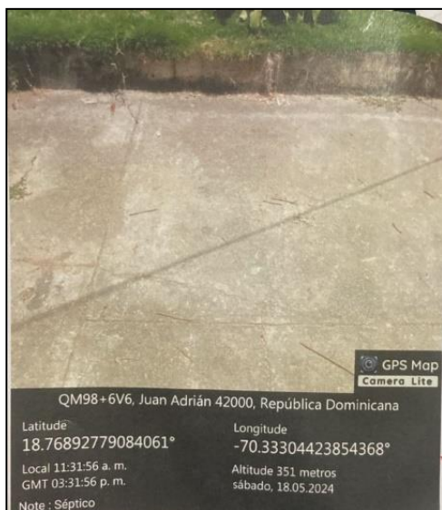
Foto 2.21A Séptico S1 cercano a la casa de empleados
