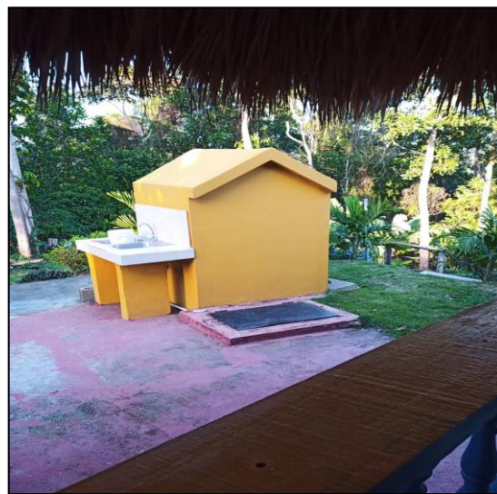
Foto 2.12C Bomba de agua sobre la cisterna A5 debajo en la casa club
