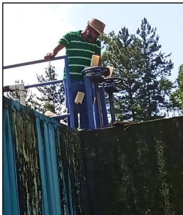
Foto 1.24 1ª Válvula de Cierre y Apertura
