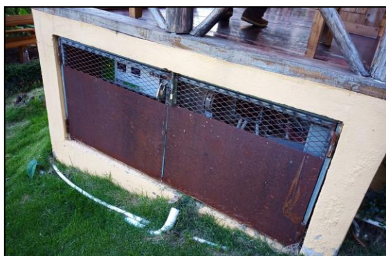
Foto 1.7D Planta Eléctrica C4 Área Casa Club
