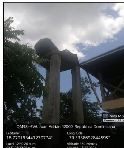
Foto 2.14 Tanque elevado de almacenamiento
