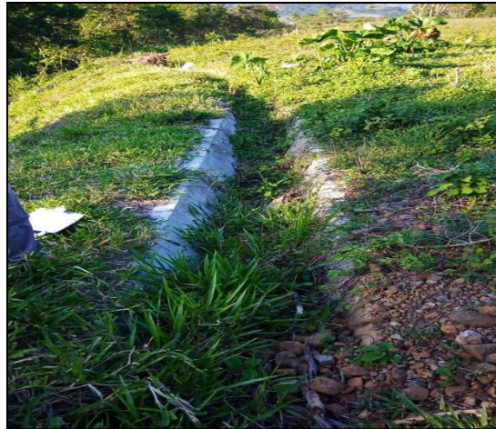
Foto 2.15 Canal de Drenaje de Captación y Conducción Parte Alta
