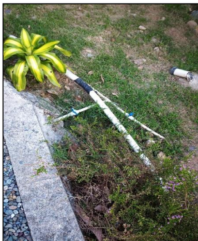
Foto 2.13 Líneas de Conducción
