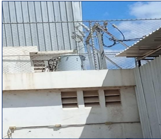
Foto 4.16 Transformador Colocado Arriba Caseta Planta Eléctrica
