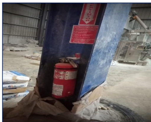
Foto 2.28B Extintor Área Proceso
