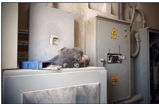
Foto 4.19 Paneles Planta Eléctrica
