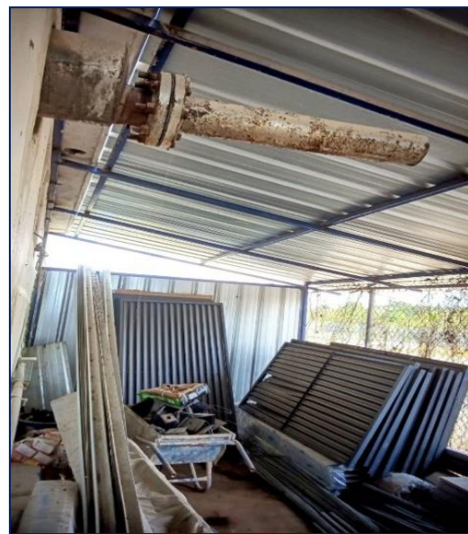
Foto 6.7 Ducto Escape Planta Eléctrica
