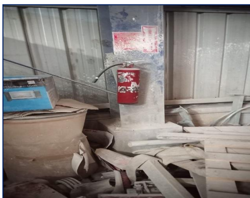
Foto 2.28A Extintor Área Línea Blanca
