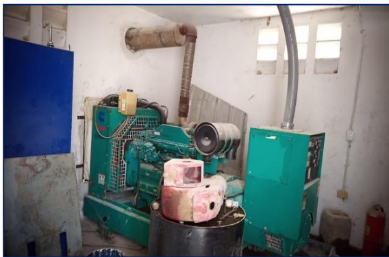
Foto 4.17 Generador Eléctrico 165Kw
