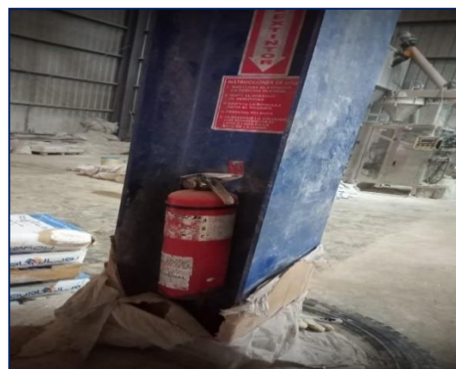
Foto 2.28B Extintor Área Proceso
