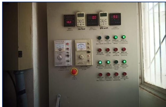
Foto 4.20 Cuartos Paneles de Mando
