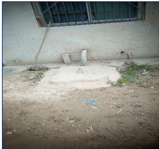
Foto 4.7 Registro Trampa de Grasa
