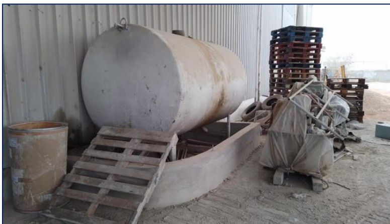
Foto 2.23 Tanque Gasoil con Tina de Protección
