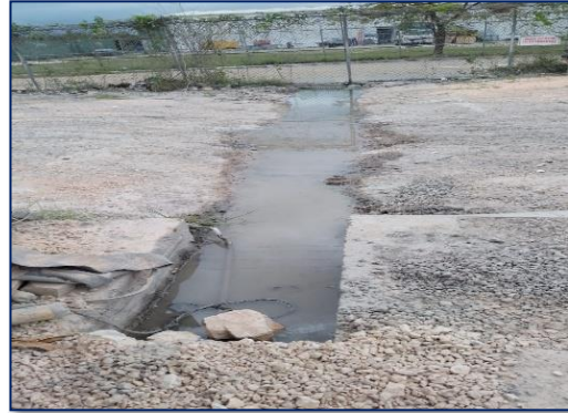
Foto 4.13 Canal sobre Suelo Compactado, de Conducción de Agua a una Parrilla y Luego a la Calle
