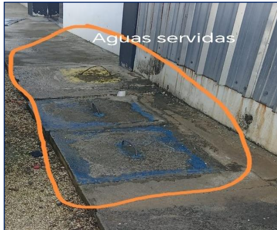
Foto 4.6 Sistema de Sépticos
