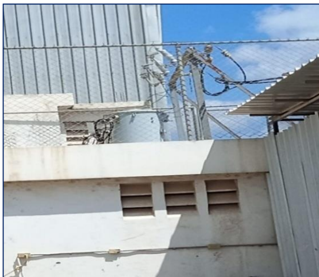
Foto 4.16 Transformador Colocado Arriba Caseta Planta Eléctrica
