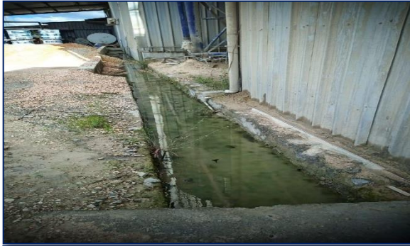
Foto 4.12 Captación y Conducción de Agua Residual Industrial
