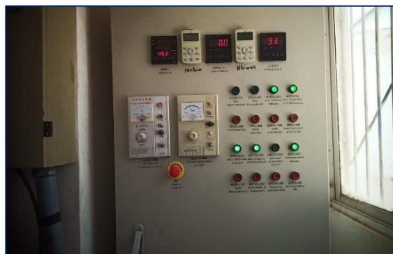
Foto 4.20 Cuartos Paneles de Mando
