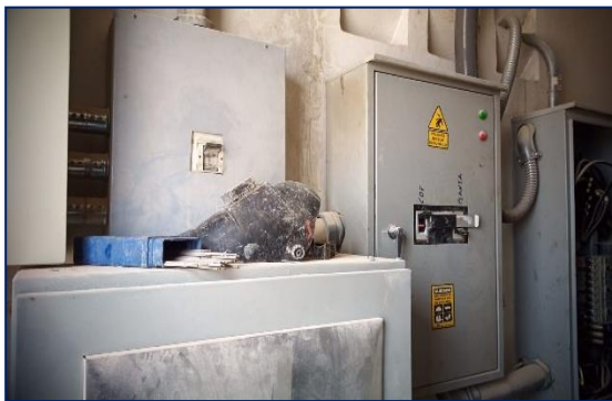
Foto 4.19 Paneles Planta Eléctrica
