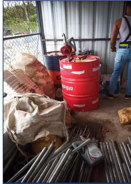
Foto 6.4 Gasoil Planta Eléctrica
