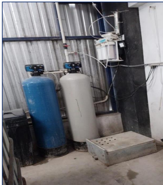
Foto 4.5 Sistema Osmosis Inversa
