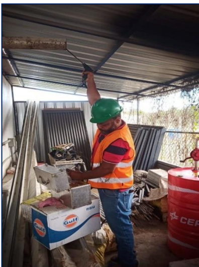
Foto 6.6 Medición Ducto de Salida Gases Planta Eléctrica
