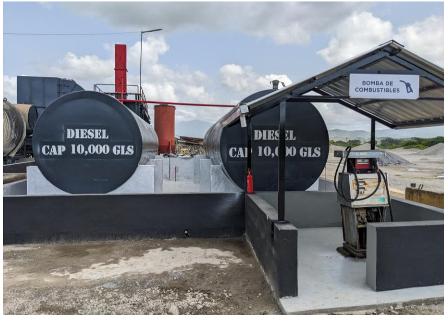
Figura No. 9.- Tanques de almacenamiento de combustibles y surtidor de combustibles.
