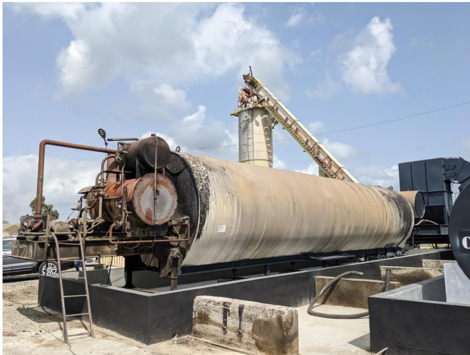
Figura No. 14.- Caldera y horno.
