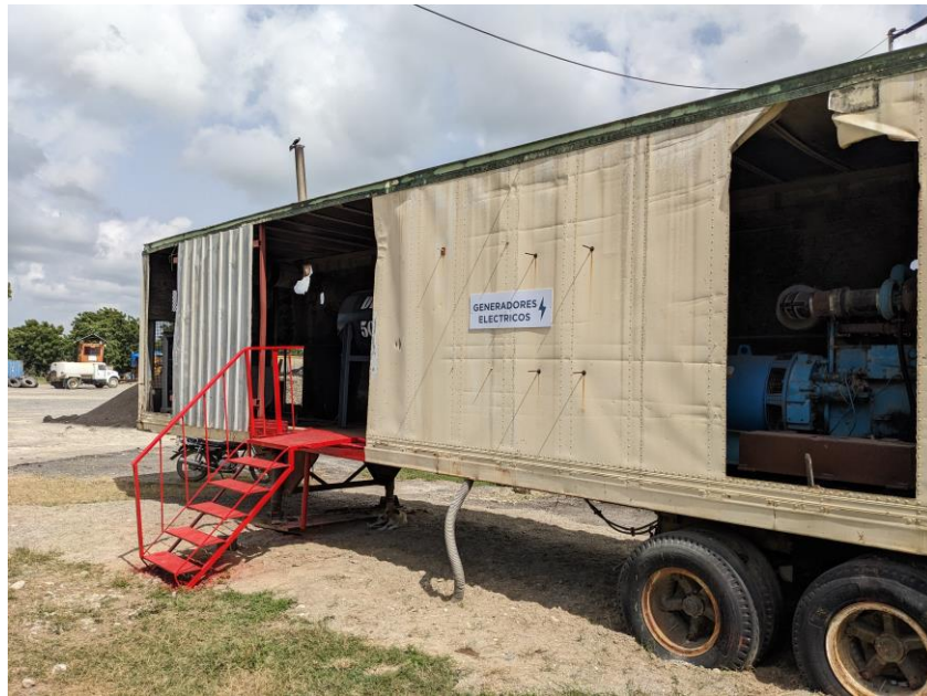
Figura No. 18.- Generador eléctrico Energy Cummins.
