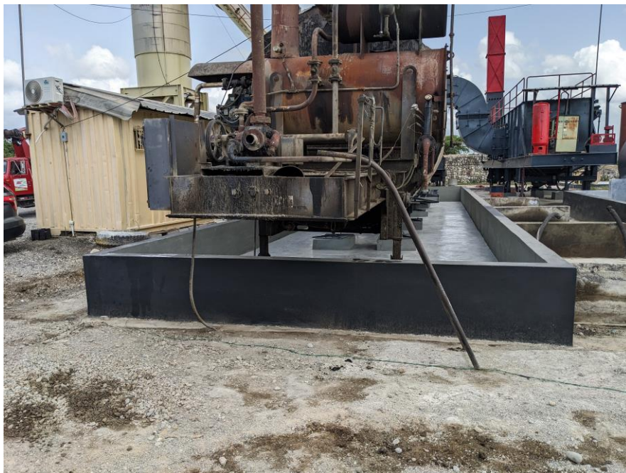
Figura No. 13.- Caldera y quemador.
