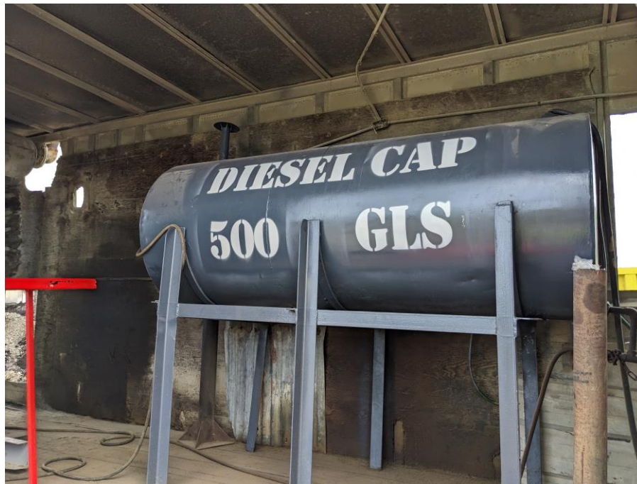
Figura No. 10.- Tanque de almacenamiento de combustible de uno de los generadores eléctricos .
