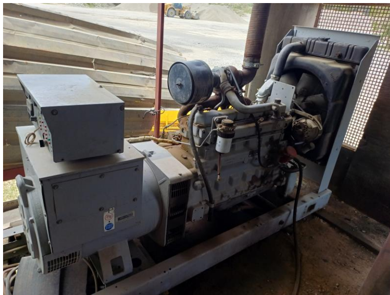
Figura No. 19.- Generador eléctrico John Deere.
