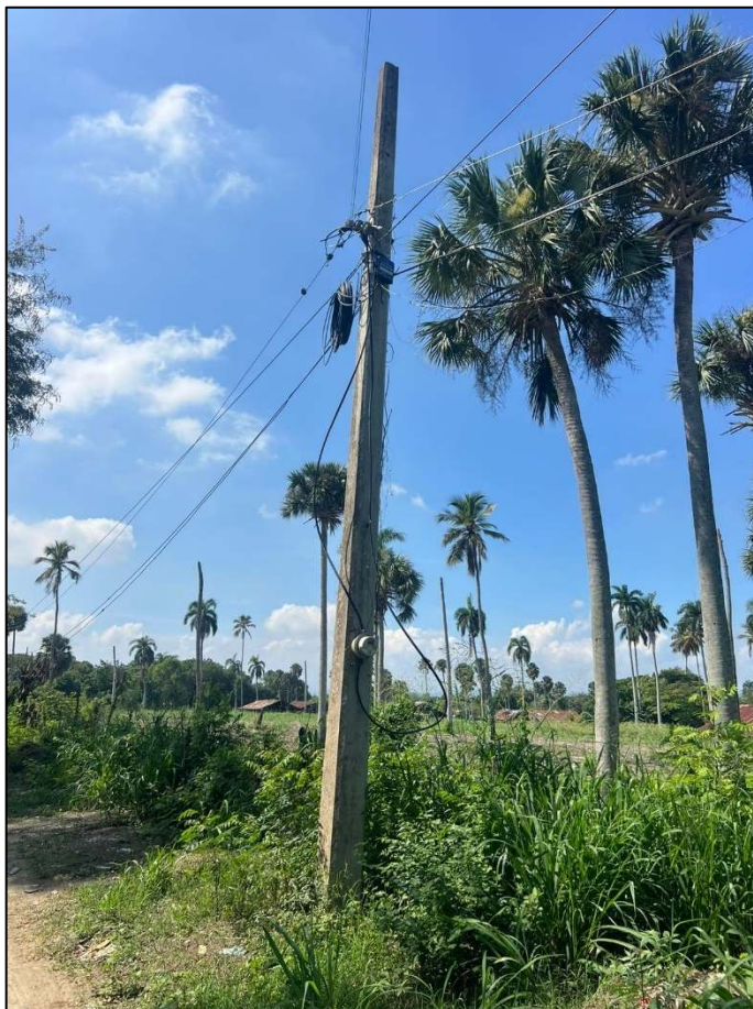
Figura 10 – Vistas de las redes eléctricas del proyecto.
